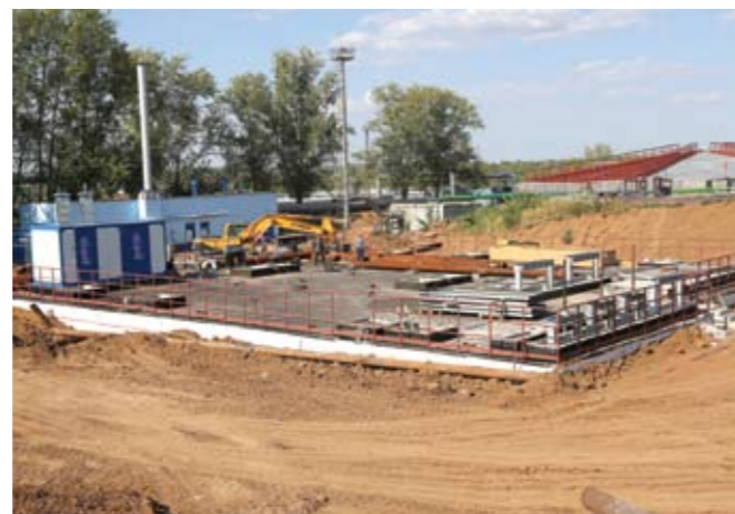
Смеситель хозяйственно-бытового и химического стоков (август 2016 года)
