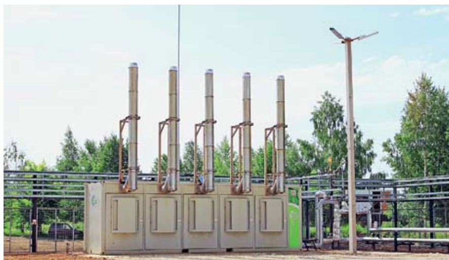
▲ ГТУ Capstone на ГЗНУ-1331 (НГДУ «Ямашнефть»)
